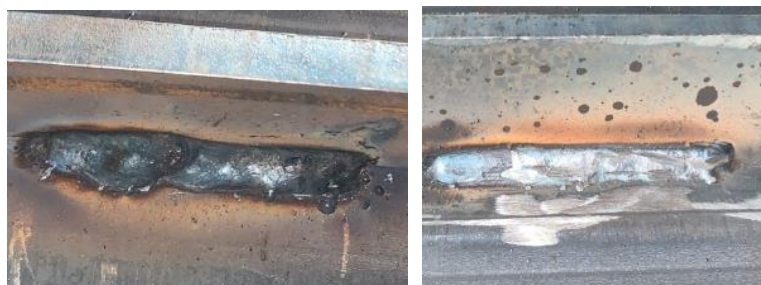
Gambar 17. Cacat pengelasan surface cold lap pada apron feeder
