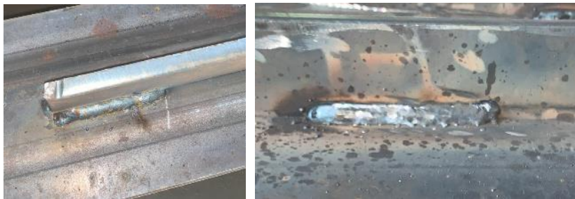
Gambar 15. Cacat pengelasan spatters pada apron feeder
