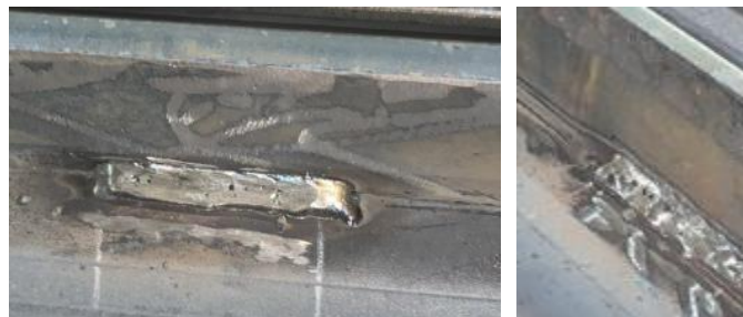
Gambar 16. Cacat pengelasan porosity & pin hole pada apron feeder
